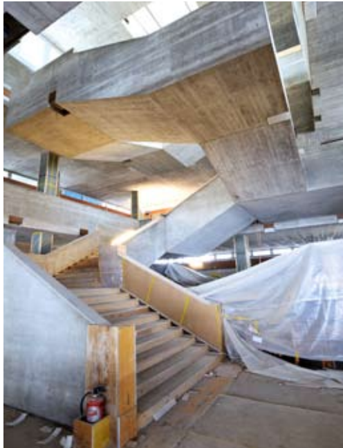
Au centre: l'escalier suspendu du grand hall du bâtiment principal de la HSG
